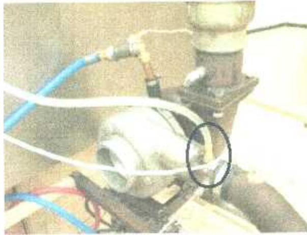
Figure 4-56 :Prise de pression sortie compresseur
