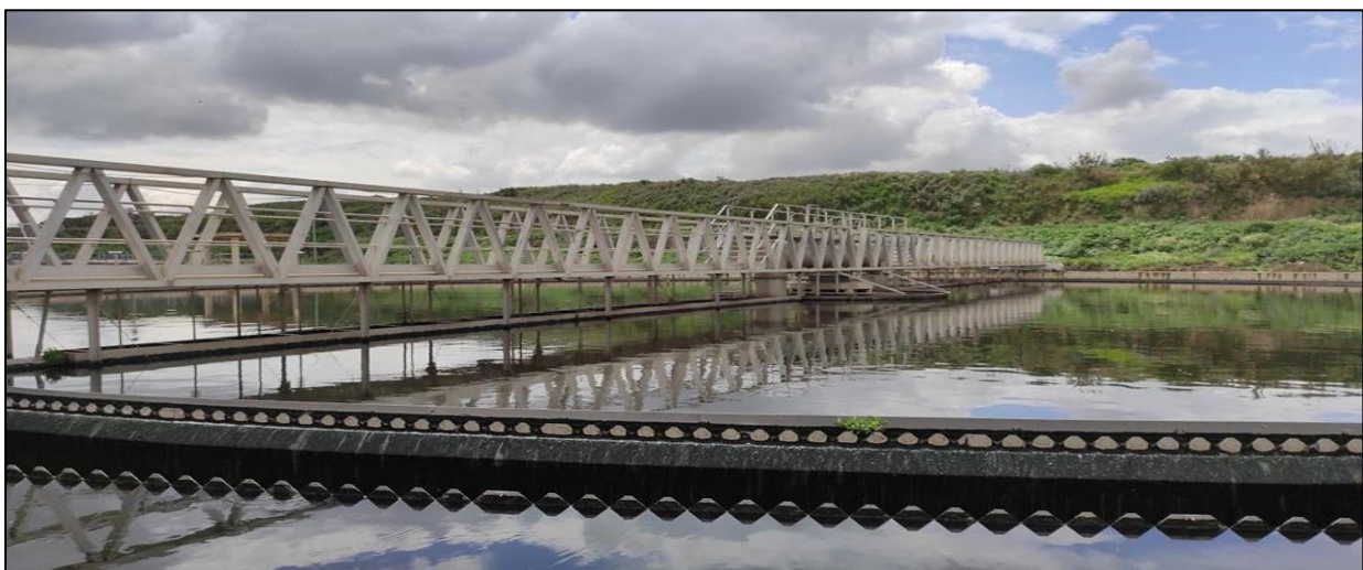
Figure II.17. Clarificateur ou bassin secondaire (prise sur terrain à STEP Baraki 2023)
