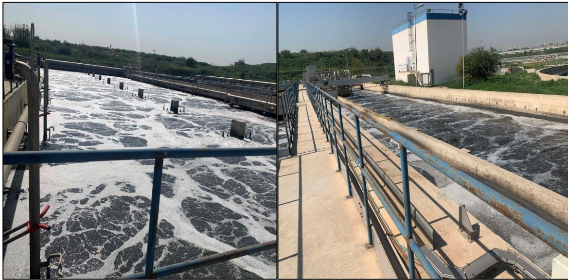
Figure II.14. Bassin d'aération de la STEP Baraki (prise sur terrain 2023)
