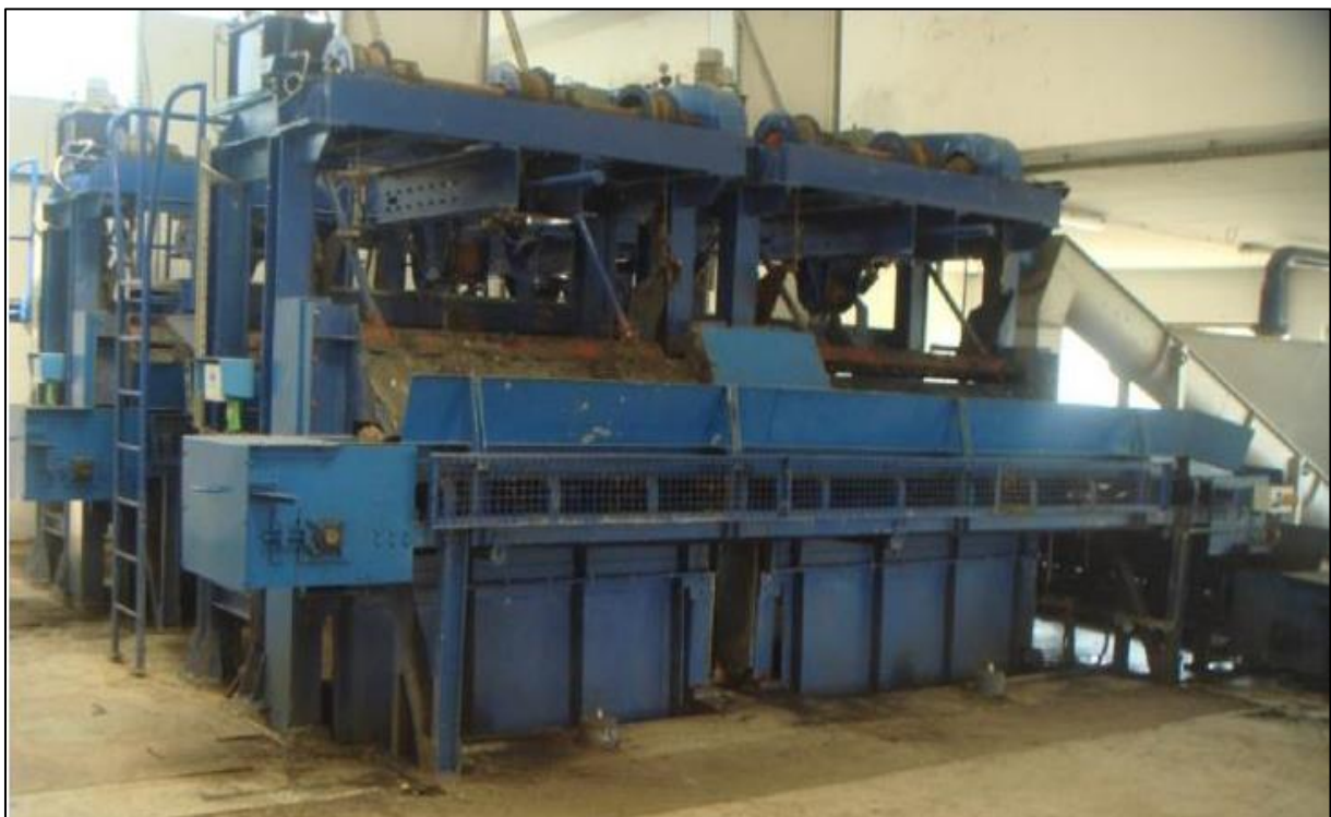
Figure II.8. Dégrilleur grossier (60mm) et fine (20mm)
