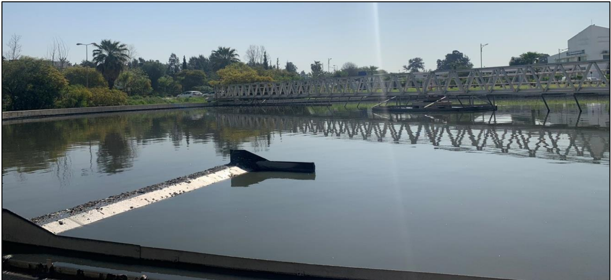
Figure II.12. Bassin de décantation primaire de la STEP Baraki, année 2023
