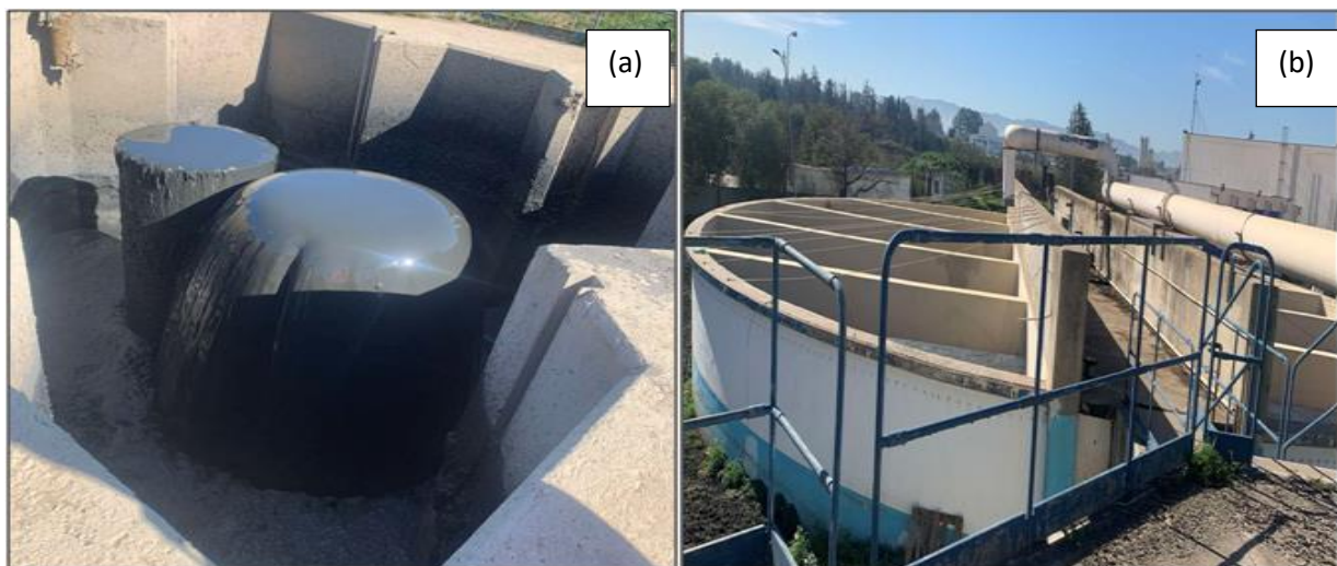
Figure II.29. (a) Boue primaire en excès ; (b) Epaisseur de la STEP Baraki 2023
