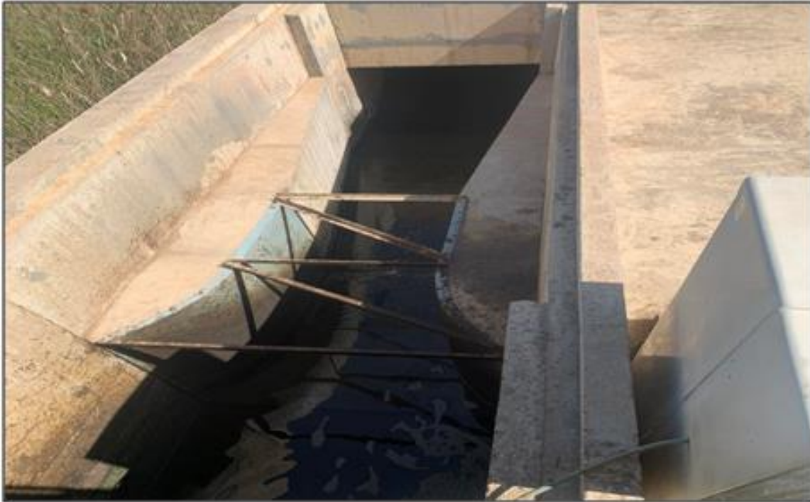
Figure II.22. Ouvrage de rejet (prise sur terrain à STEP Baraki 2023).
