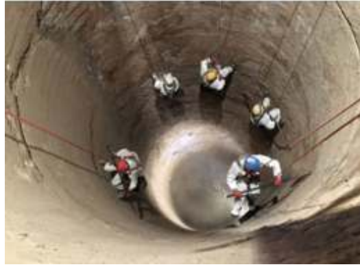
Figure IV.13 : Dégradation des parois d'un silo par les fines particules.
