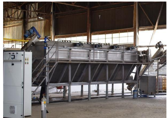
Décanteur après lavage.
