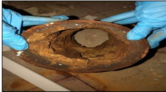
Figure 3.3: Dépôt de Sulfates de Calcium ( \text{CaSO}_4 )
