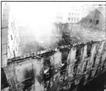
FIG I.12 : Immeuble ravagé par l'incendie 2016. Source : www.libertie-algerie.com
