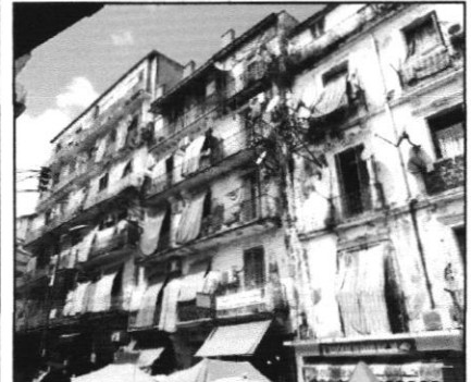
FIG I.17 : Vétusté de bâtis de la cité Bugeaud. Source : Auteurs 2018.
