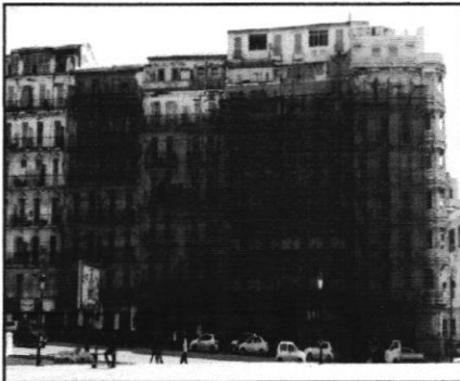
FIG I.15 : Bâtiment dégradé à Bâb el oued. Source : Auteurs 2018.
