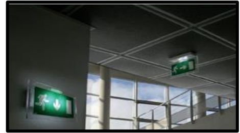
Figure 116 : les issues de secours.
