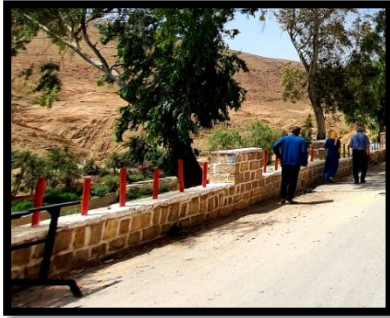
Figure 55: mur de la corniche
