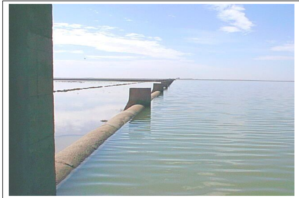
Figure 2.9 Blocage de la vanne de la digue sud du barrage de Boughzoul
