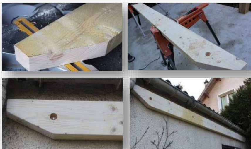
Figure 142 : Préparation et installation du bastaing Source : Vince,2014, [Pergola Dossier 1] Le scellement chimique Fischer
