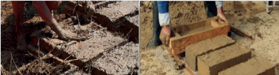
Figure 19 : Fabrication de la brique d'adobe Source : OLIVA JP., COURGEY S, L'isolation thermique écologique. Mens : Terre Vivante,
