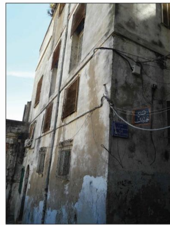
C Façade du bâtiment en mauvais état
