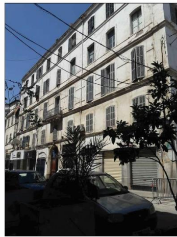
E Façade du bâtiment en moyen état
