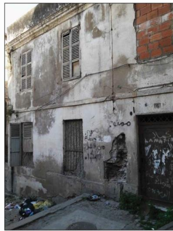
A Façade du bâtiment en mauvais état
