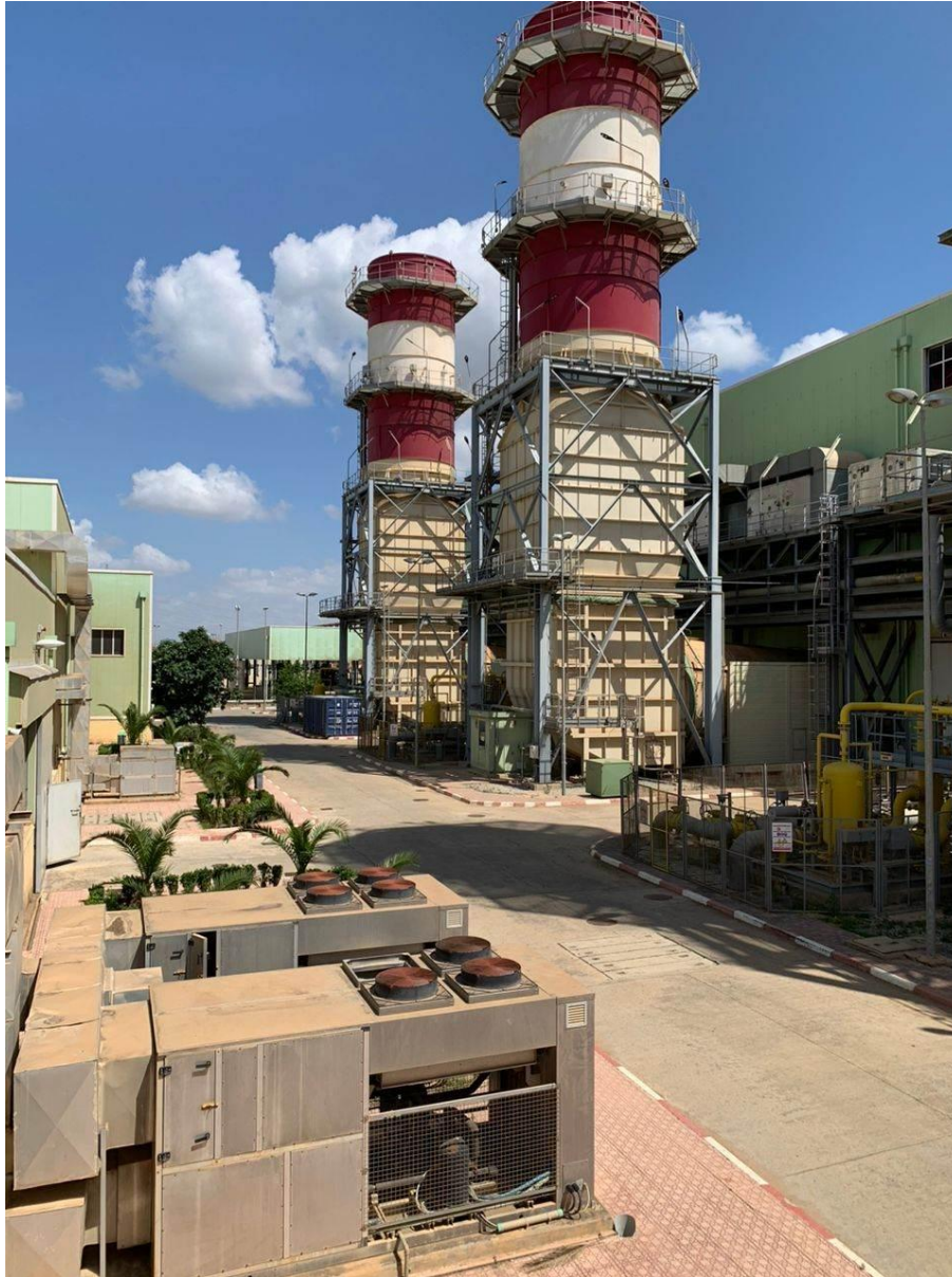
Figure 1.1 : centrale électrique « LARBAA » (originale 2023)
