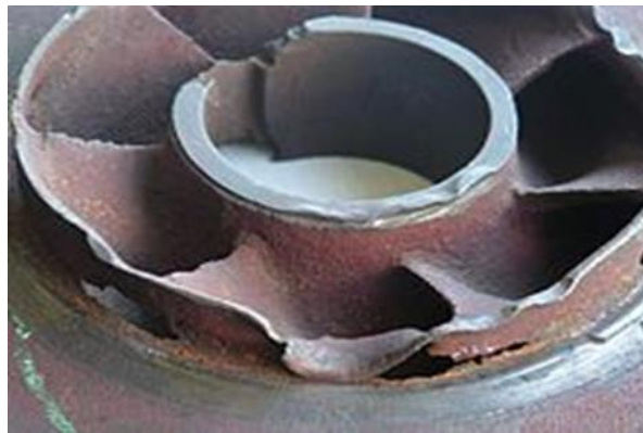
Figure (2. 12): Dégâts de Cavitation sur les éléments d'une pompe centrifuge.
