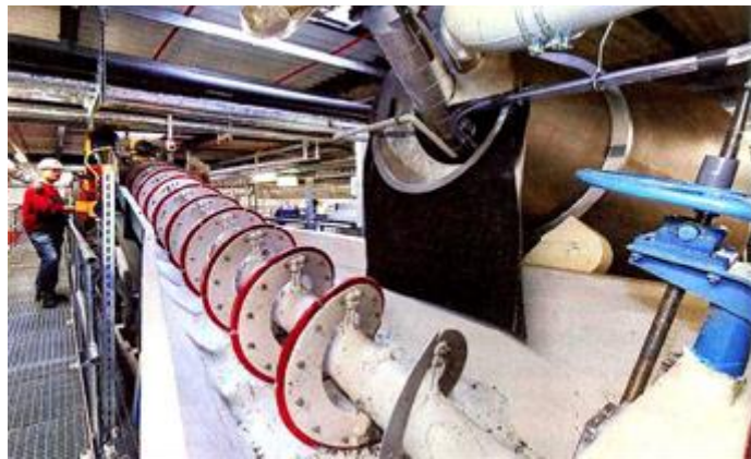
Figure I-7: Vue d'une installation de récupération du verre. Après broyage, le verre est transporté à l'aide d'une vis sans fin, vers le lieu de stockage [79]
