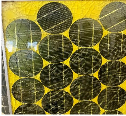
Figure II -2: Dégradation de la couche EVA et création de point chaud à la surface du model PV.
