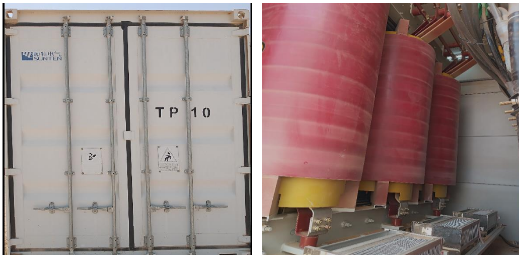
Figure(III.7) : transformateur élévateur de la marque SUNTEN. [26]
