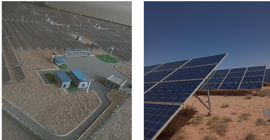
Figure(III.2) : Les champs solaires PV de la centrale d'El Kheneg (Laghouat). [26]
