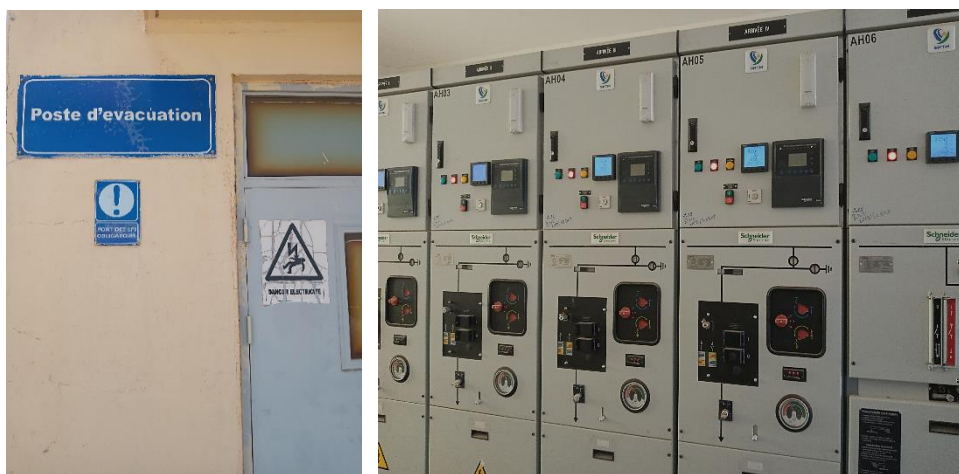
Figure(III.9): Le poste d'évacuation de la centrale de 30KV. [26]
