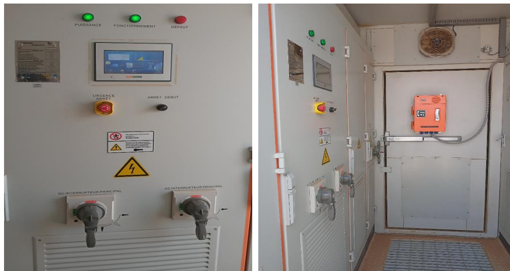
Figure(III.6) : L'onduleur de la centrale PV d'El Kheneg (Laghouat). [26]
