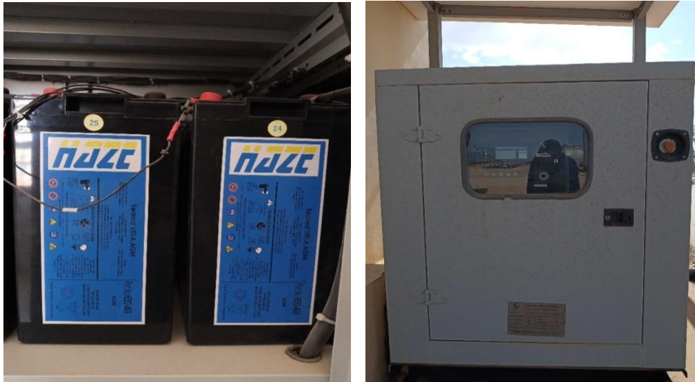
Figure(III.10): Groupe diesel et batteries utilisés. [26]
