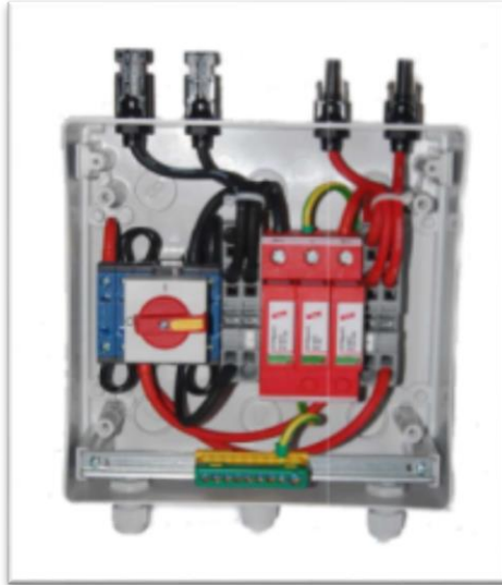
Figure (II.6): Intérieur d'un coffret de protection courant continu. [14]
