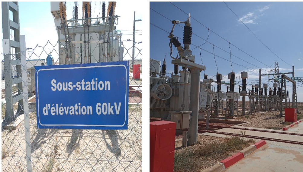
Figure(III.8): Transformateur de la centrale d'El Kheneg (Laghouat). [26]
