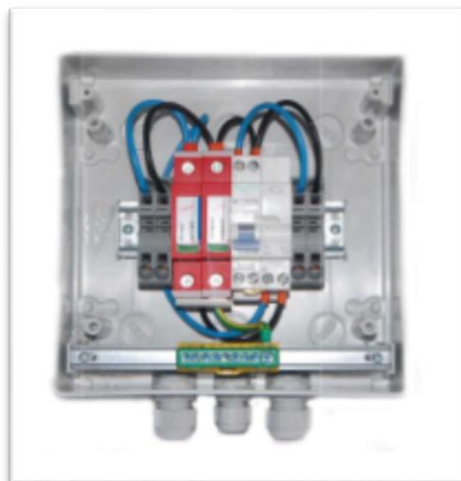
Figure (II.7): Intérieur d'un coffret de protection courant alternatif. [14]
