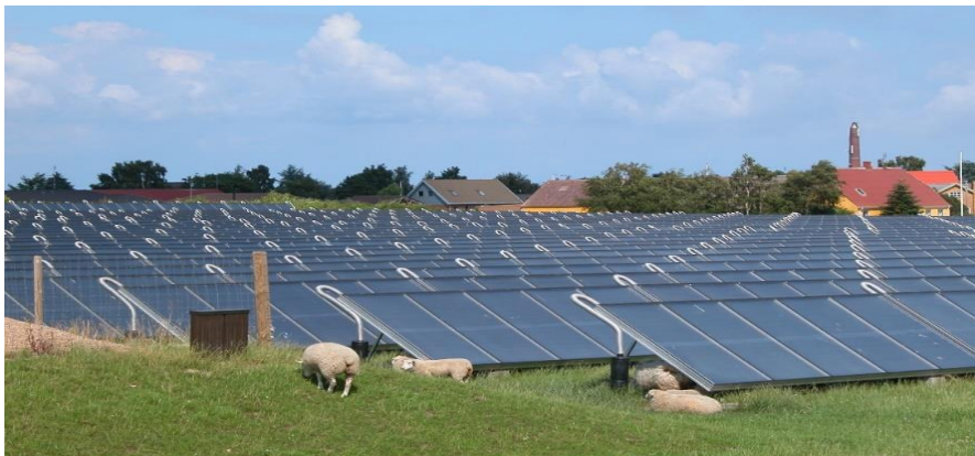
Figure (I.1): Un champ de capteurs solaires au sein d'une centrale de chauffage solaire.
