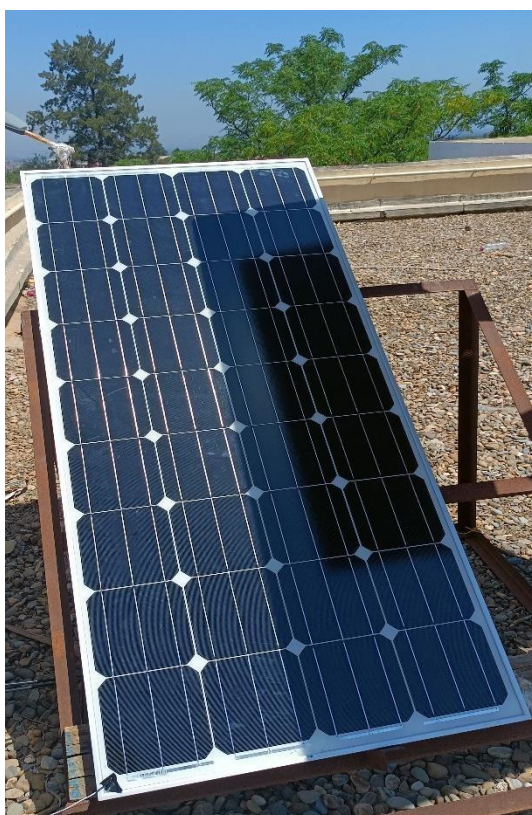
Figure (IV.12) : Panneau PV N°3 ombragé.
