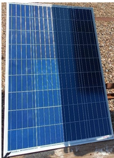
Figure (IV.8) : Panneau PV N°2 ombragé.
