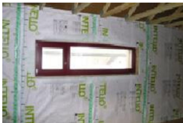
Figure I. 13: Frein vapeur en ossature bois : les laies sont scotchées entres elles avec un adhésif spécifique.[12]
