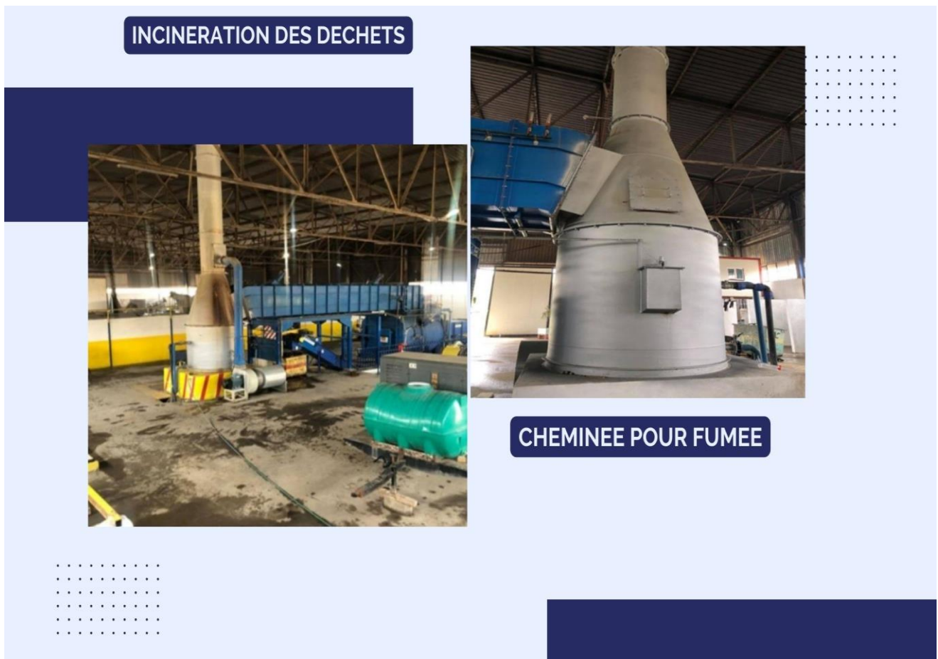
Figure III .8: Installation d'incinération de l'EPWG -CET
