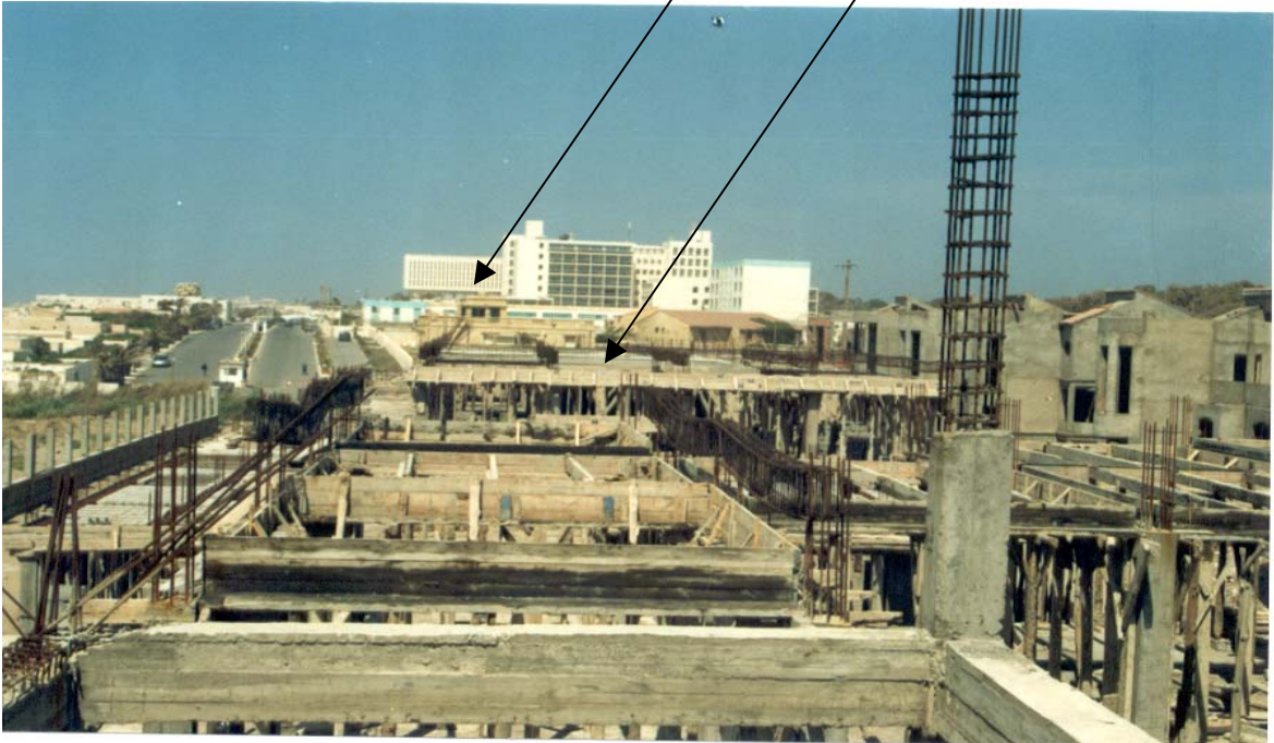
4.11.C: Rupture entre l'ancien complexe et la nouvelle ZET (Source : photopersonnelledel' auteurpriseenMai2004)
