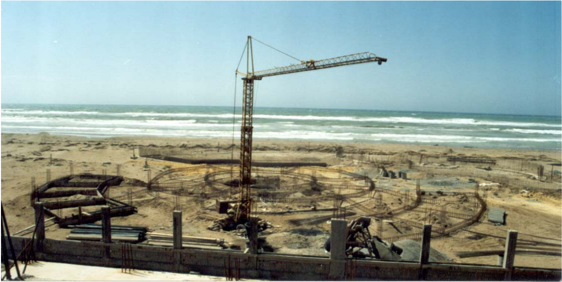
4.11.B : De grands travaux de « Terrassement » (Source : photo personnelle de l'auteur prise en Mai 2004)
