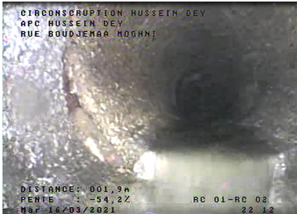
Figure I.8: dégradation de surface.
