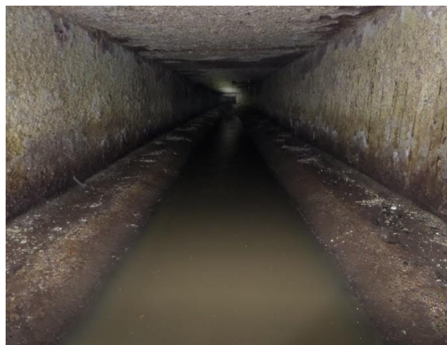
Figure V.12: Travaux de Diagnostic et d'auscultation physique du collecteur ENRIC mené à l'intérieur del'ouvrage pour le tronçon au niveau de la section (C)
