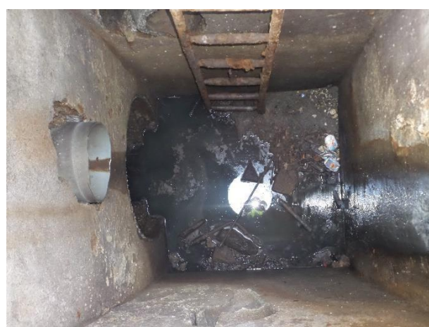
Regard Collecteur Ø800mm-Tronçon Amont Section (A)
