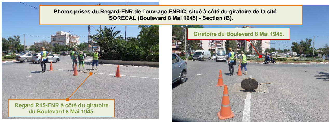
Figure V.9: Diagnostic du collecteur ENRIC pour le tronçon au niveau de la section (B).
