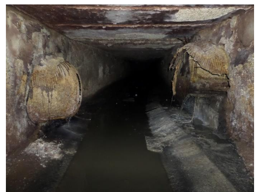
Figure V.8: Diagnostic du collecteur ENRIC pour le tronçon au niveau du changement de la section, de la section (A) vers la section (B).
