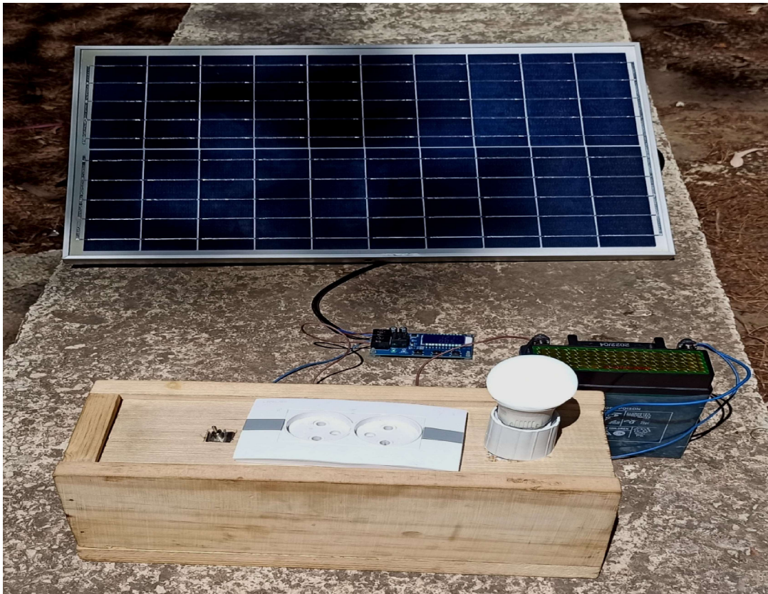
Figure III. 19 : Notre système photovoltaïque en état de fonctionnement.
