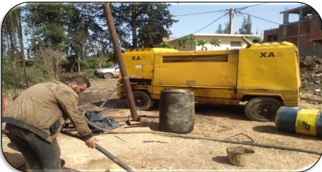
Figure IV-13 : Photo d'un compresseur de 16 bars
