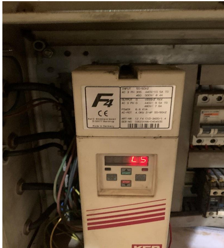
Figure II 4 : Variateur électrique dans le chariot
