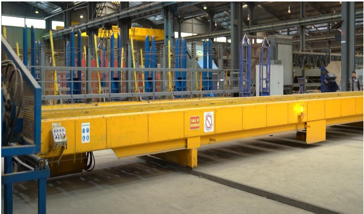
Figure III 1 : chariot électrique de transfert sur rail
