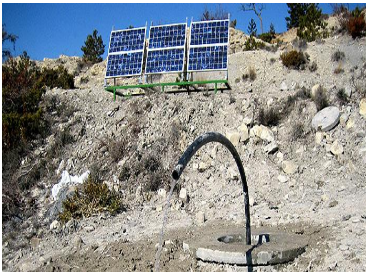
Fig.3.21. pompe écologique utilisant l'énergie solaire
