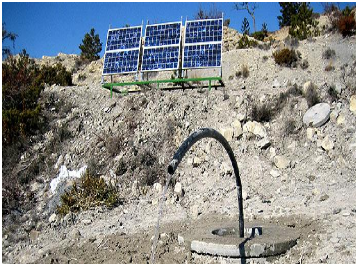
Fig.3.21. pompe écologique utilisant l'énergie solaire
