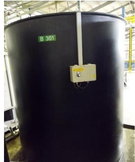
Figure 19 Un réservoir de stockage d'eau.
