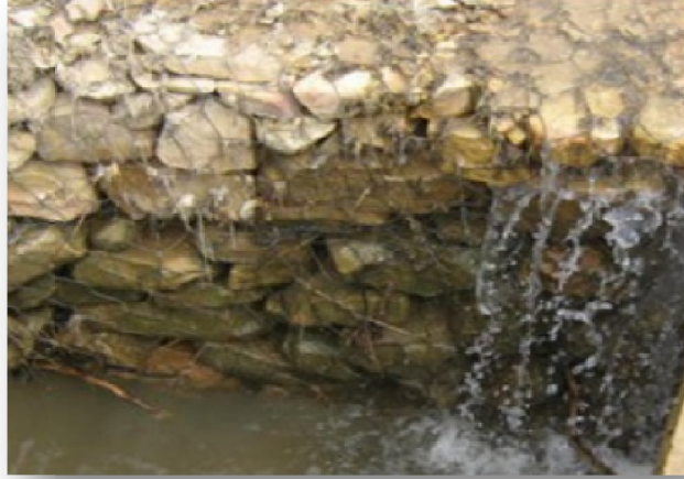
Photo III.2: Seuils de sédimentation en Gabions et en pierres sèches réalisés dans le bassin Versant du barrage BAKHADDA. (SERBAH B., 2011)
