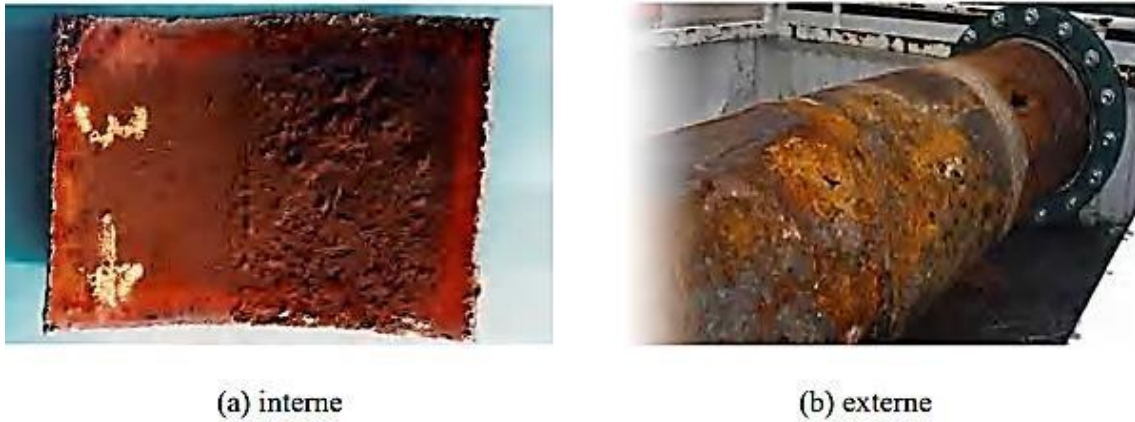
Figure 1.3: Corrosion dans les pipelines
