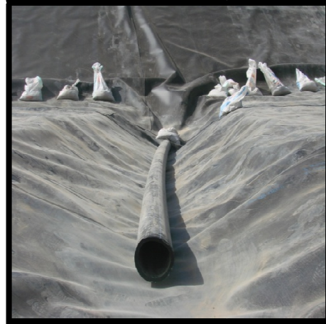
Photo 15 : caniveau de collecte des lixiviats
