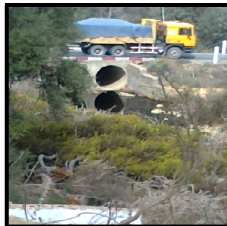
Photo 26: Pollution des eaux de Oued par lixiviat
