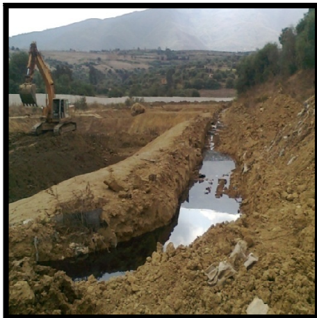
Photo 25: Fuites des digues des bassins de stockage de lixiviat
