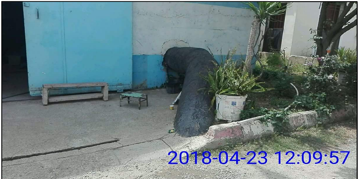
Figure (III.3) : Vue extérieure de la conduite d'arrivée de la station de Béni Tamou.
