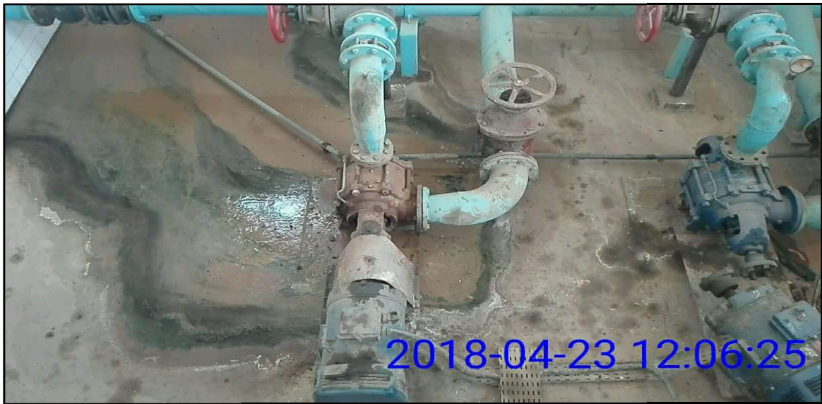
Figure (III.6) : Vue intérieure des éléments de la station de pompage.
