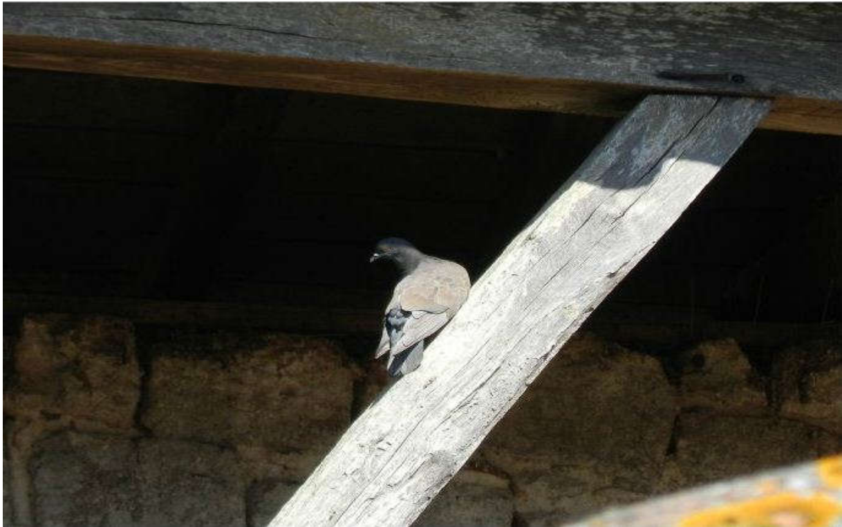
Figure 3.5 : pigeon dans une charpente de maison (Photo google).
