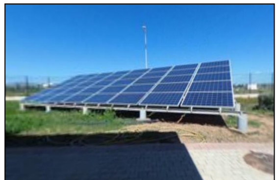
Figure 43 : pompe solaire. Source : ifmeree.
