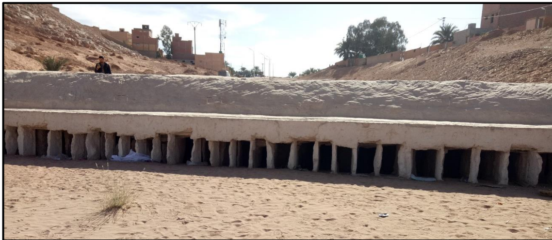
Figure 195 : Les canaux de récupération et drainage d'eau Source : photo prise par auteur
