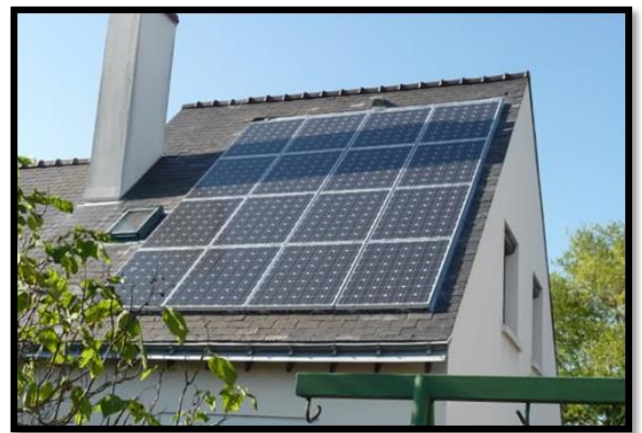
Figure (I.11) : L'ombrage des modules photovoltaïques [13].
