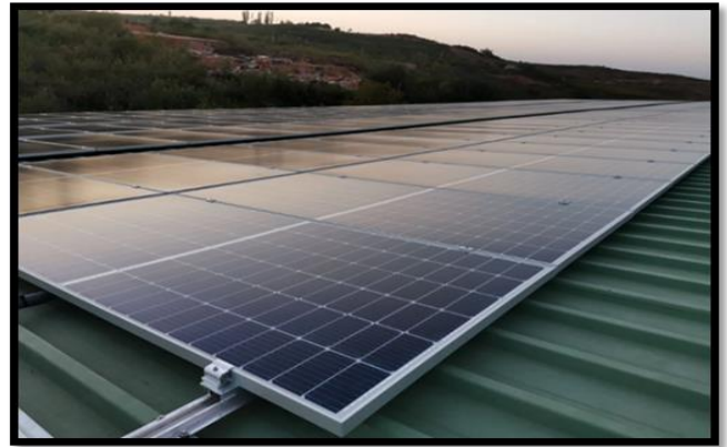
Figure (I.10) : Des panneaux photovoltaïques [11].
