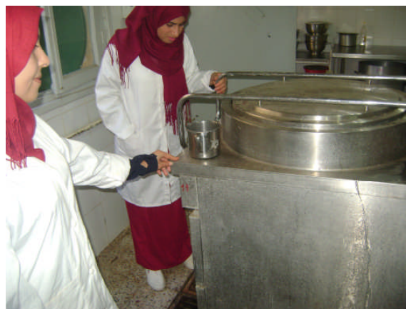
Photo n° 5 : Contrôle Physique (état de la Marmite professionnelle)
