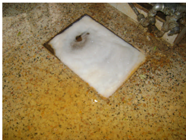
Photo n°7 : Evacuation des eaux difficile Avaloire bouché
