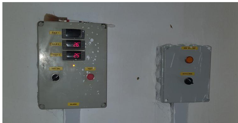
Figure 13 : Thermostat et Alarme.
