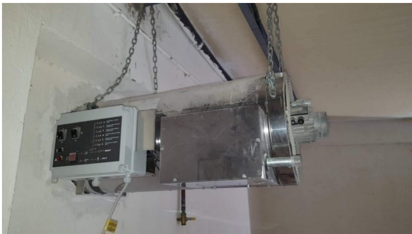
Figure 18 : Chaudière à gaz de ville.
