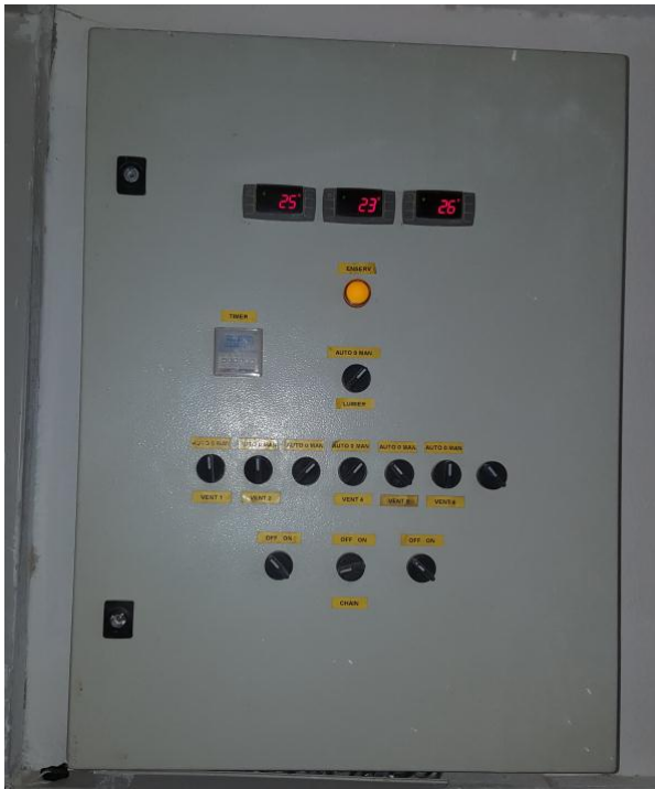
Figure 12 : Armoire des commandes.
