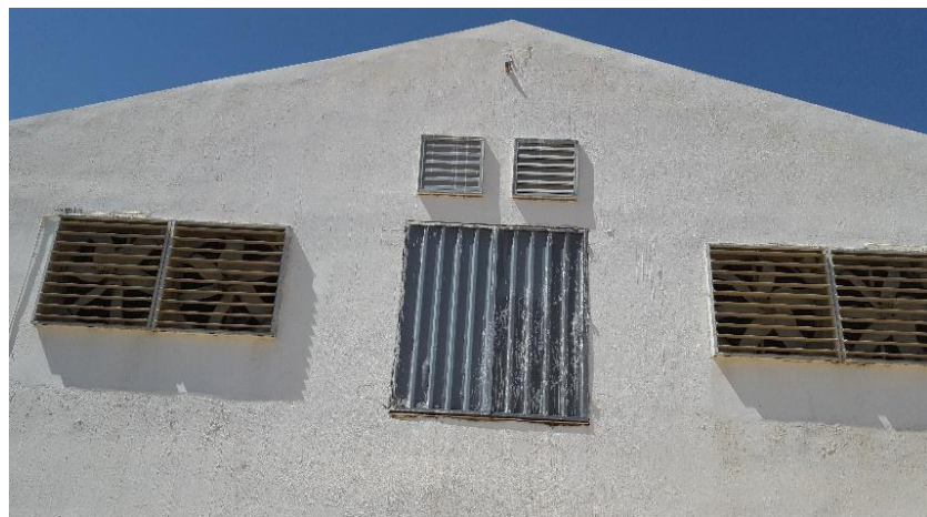
Figure 15 : Ventilation vue externe
