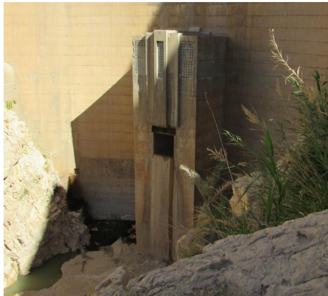
Fig. 3.6. Vanne de fond du barrage de Foug El Gherza souvent bloquée par les palmiers arrachés par les crues (Photo. Mai 2016)
