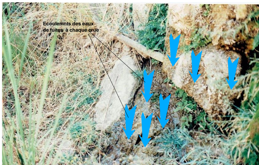
Fig. 3.20. Traces de ruissèlements des eaux de fuites en période de hautes eaux (photo. 1998)
