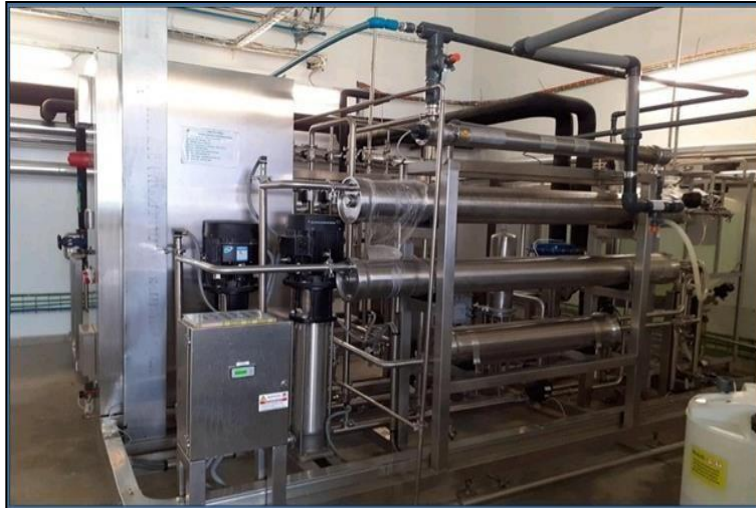
Figure 29 : Station de traitement d'eau industrielle par osmose inverse
