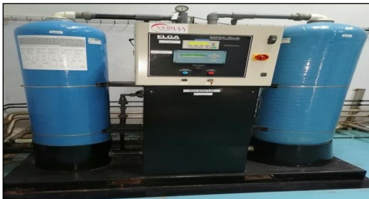
Figure 26 : Station de déminéralisation par permutaton d'eau brute
