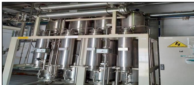
Figure 37 : Station de traitement d'eau brute par distillation (MED)
