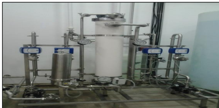
Figure 34 : Station de traitement d'eau par d'ultrafiltration
