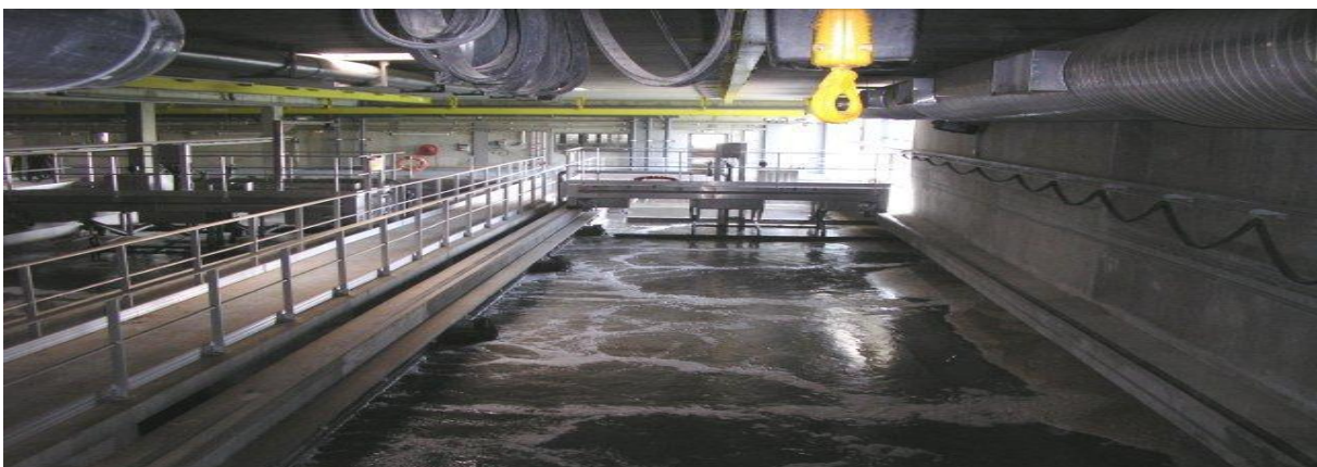
Figure II.3 : Dessablage, déshuilage et dégraissage dans un seul ouvrage [5].
