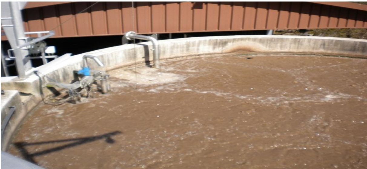
Figure II.20 : bassin d'aération (procédé à boues activées) [l].
