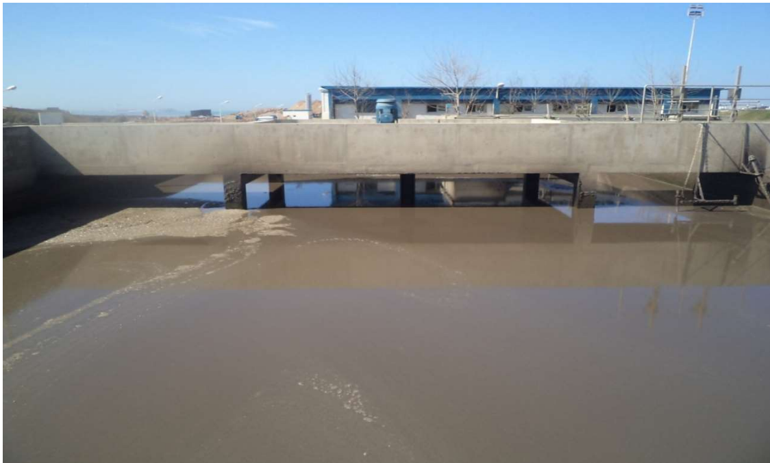
Figure V.6 : Bassin de stabilisation de la STEP de Béni-Messous.
