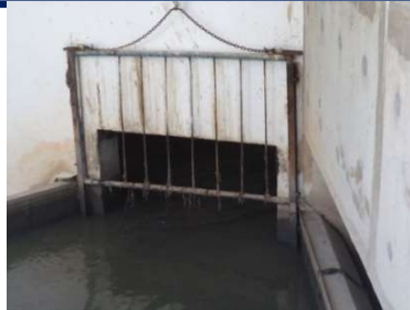
Entrée des eaux usées
