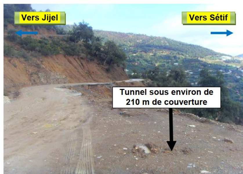
Figure II-10 : Exemple de décrochement existant le long de la CW137A situé à 210 m environ.
