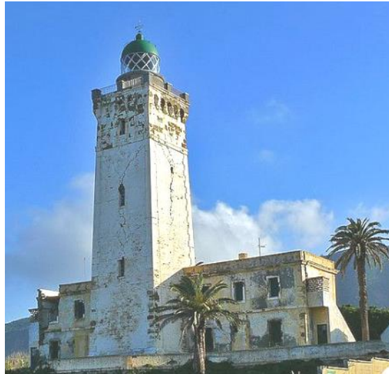
Figure 5.8 : l'état de conservation du phare de cap Bengut après le séisme de Boumerdès 2003 (180) .
