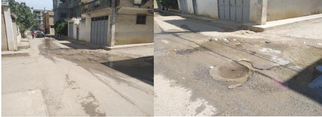
Figure 14:Fuite sur une conduite DN125-AC (Lotissement Mahi)
