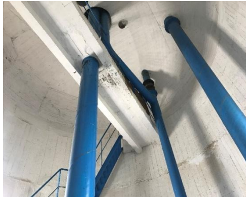
Figure 19: L'intérieur du château d'eau CH1000 m 3 de Brissonier
