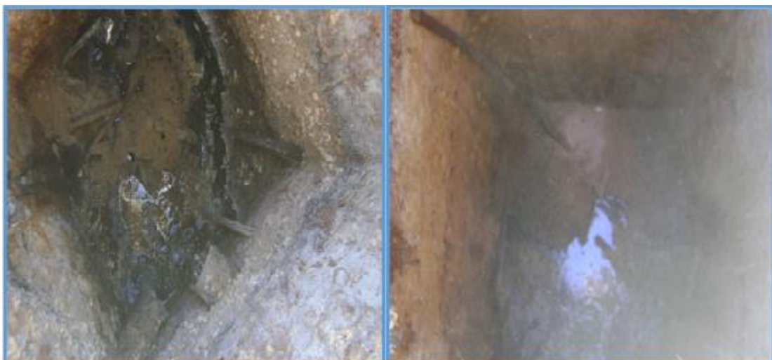
Figure8: déchets bouchant les regards.
