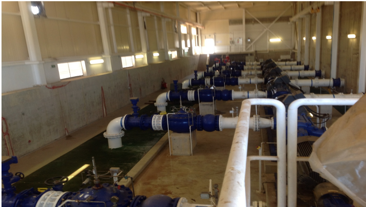
Figure V-14 : Station de pompage d'eau traitée, [source: MESLEK.F].
