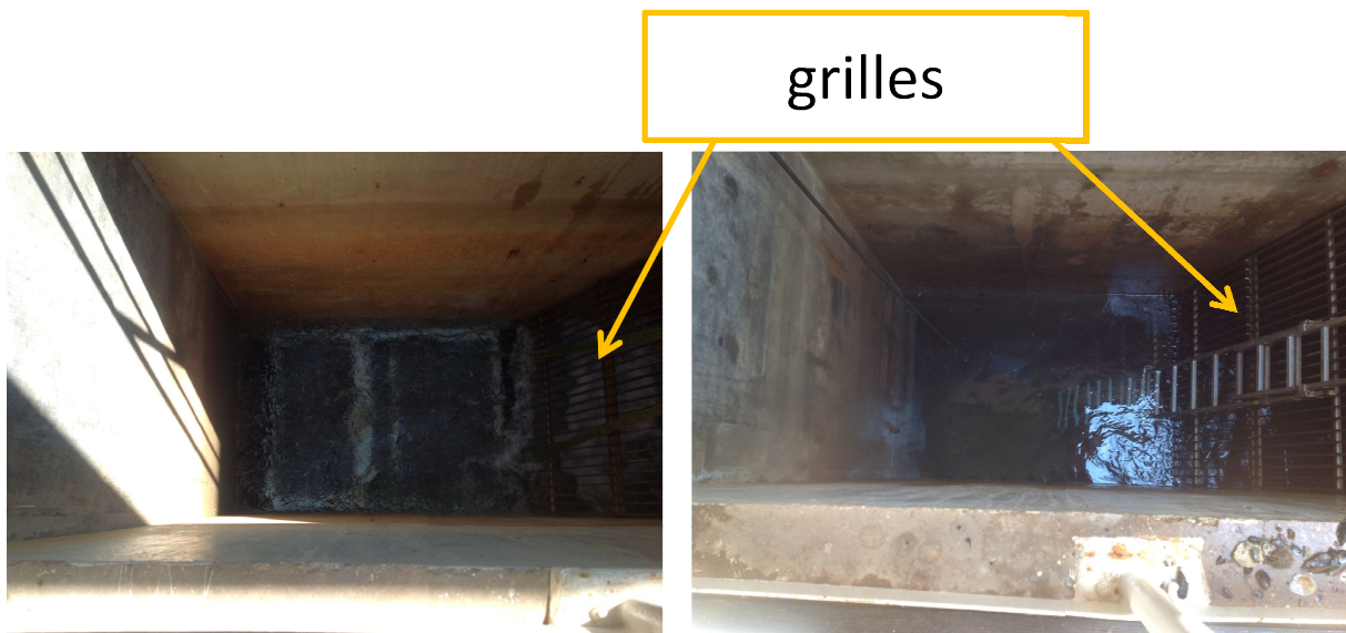
Figure V-4 : Dégrilleurs, [ source: MESLEK.F].
