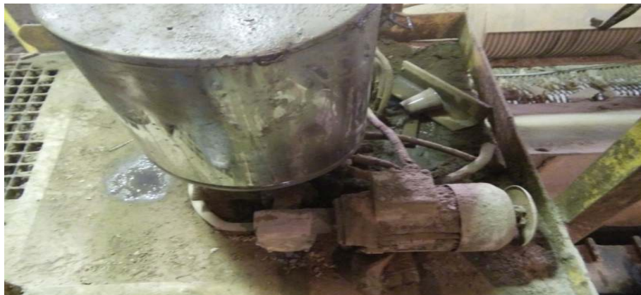
Figure 2.6 : vue sur la pompe de graissage
