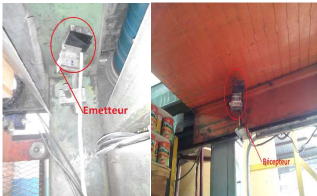
Figure 2.6. Emplacement de deuxième photocellule émetteur/récepteur dans le palettiseur.
