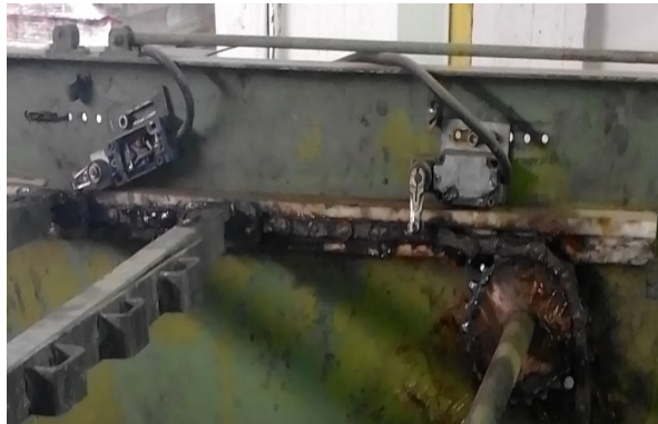
Figure 2.8. Emplacementdes deux capteurs de position mécanique.
