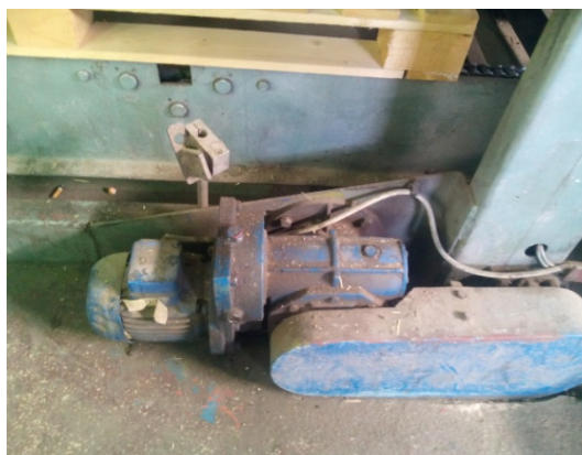
Figure 2.14. Emplacement du moteur de l'élévateur de la pile des palettes vides.
