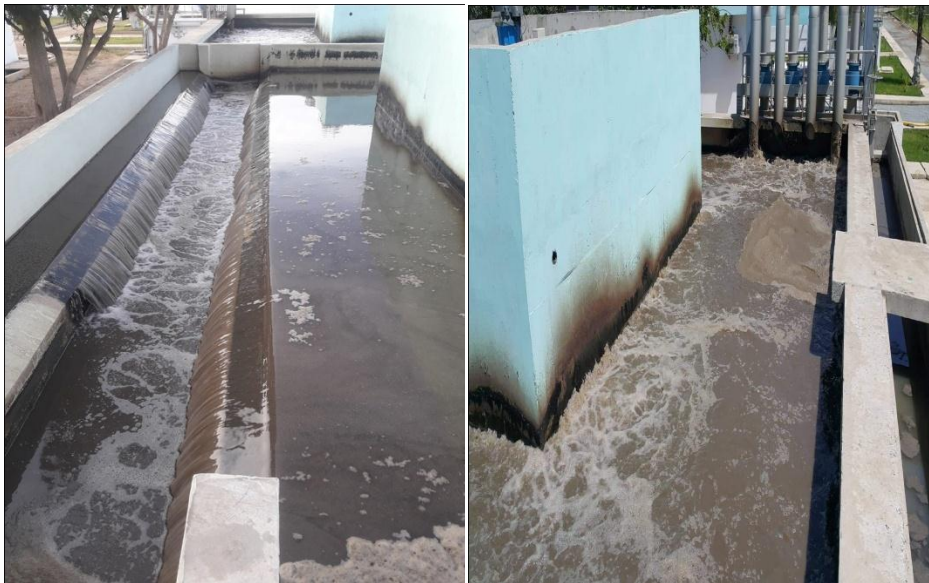
Bassin d'aération de la STEP de Béni Mered ( Photo originale ).
