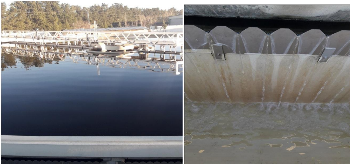
Clarificateur de la STEP de Béni Mered ( Photo originale ).
