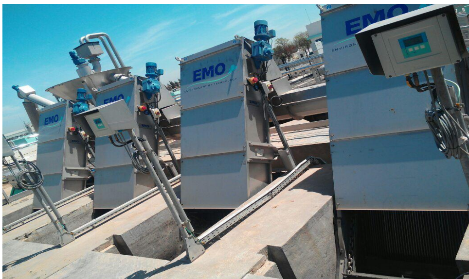
Dégrilleurs automatiques (Photo originale)
