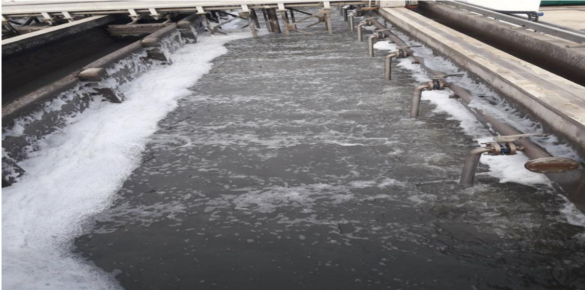
Dessableur dégraisseur de la STEP de Béni Mered ( Photo originale ).
