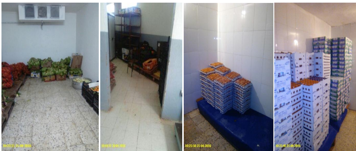
Figure03 : chambres froides au niveau des 3 restaurants universitaires inspectés.
