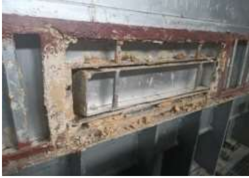
(a) Logis de refroidisseur mal étanché
