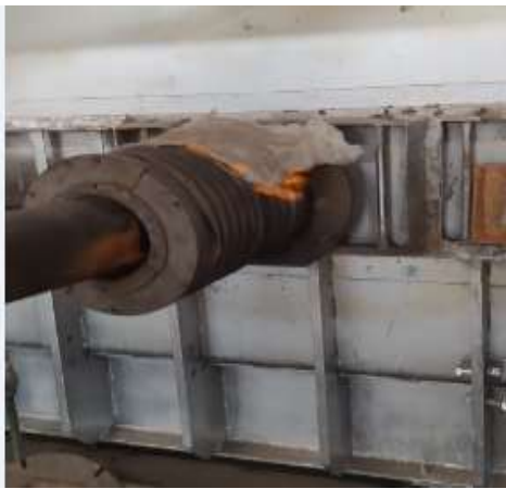
(c) Mauvaise étanchéité, sortie de flamme
