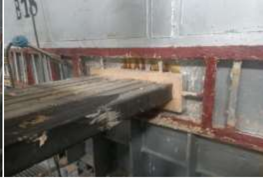
(b) Refroidisseur en fonctionnement, bonne étanchéité du logis
