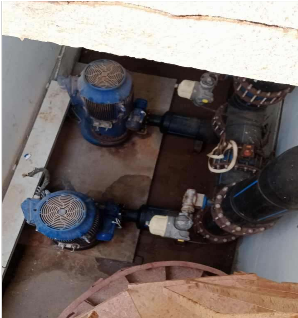
Figure 3. 4 : les pompes centrifuges à axe vertical de 500 m 3 /h.
