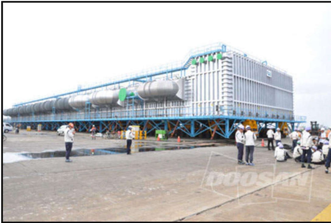
Figure 1. 2 : station de dessalement Ras El Khair dans Arabie saoudite. ( Technology , 2017)
