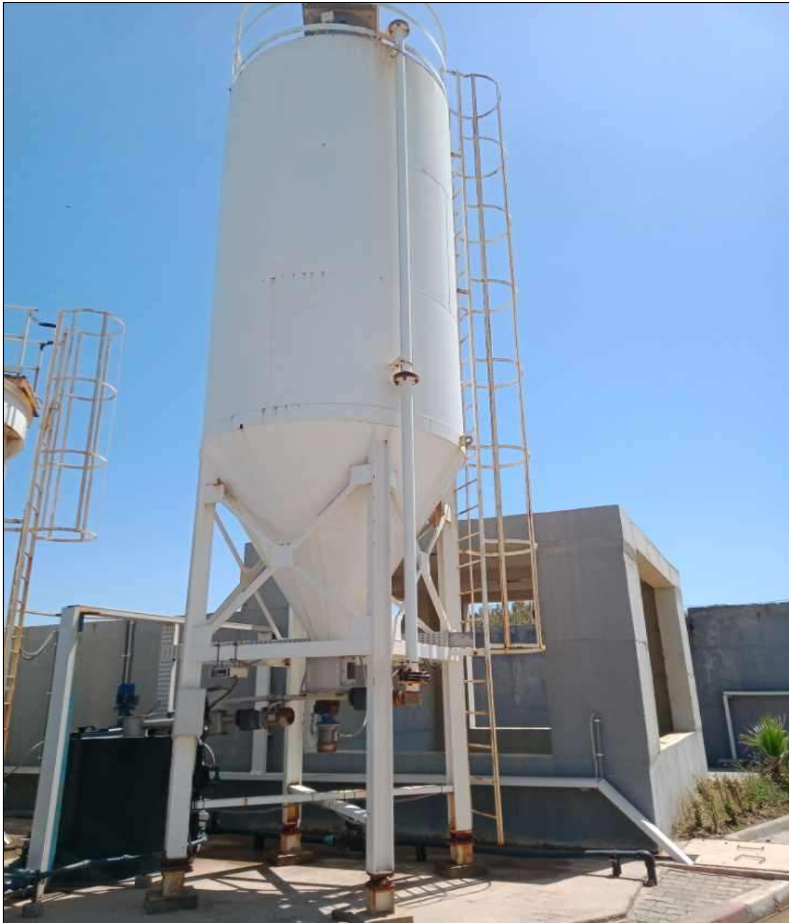
Figure 3. 10 : cuves de préparation de lait de chaux.
