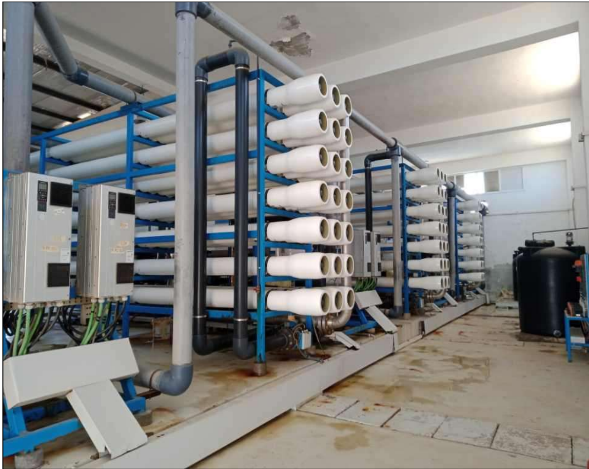
Figure 3. 9 : le bloc de l'osmose inverse.
