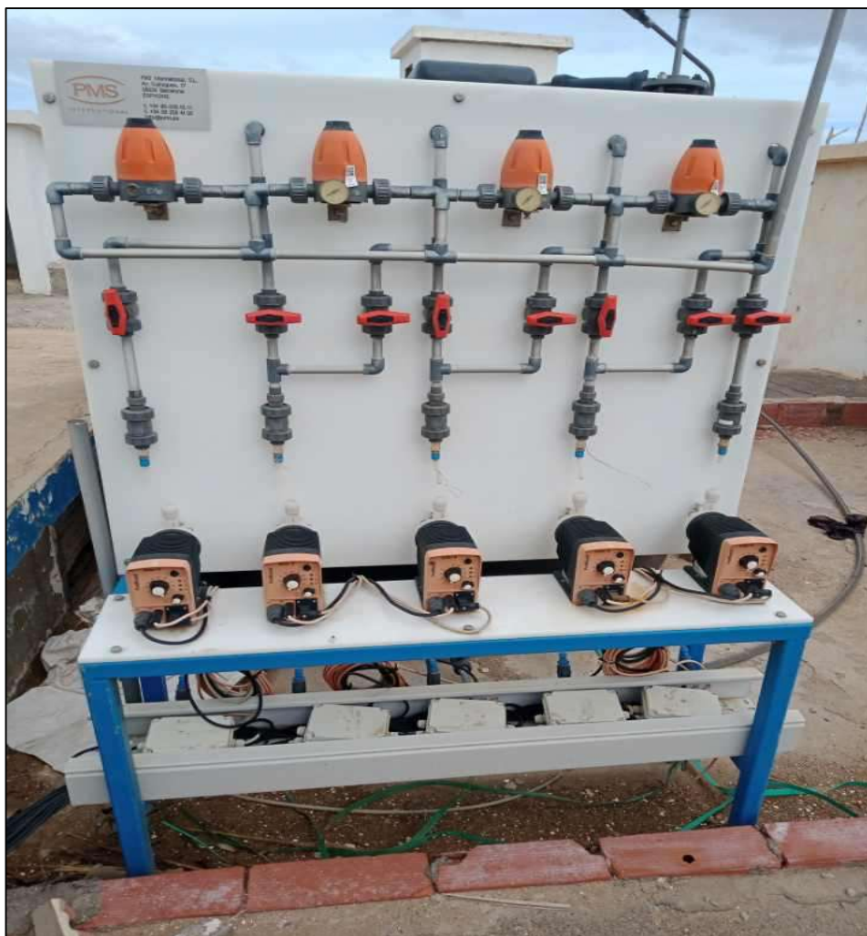
Figure 3. 8 : dispositif de dosage d'hypochlorite de sodium.
