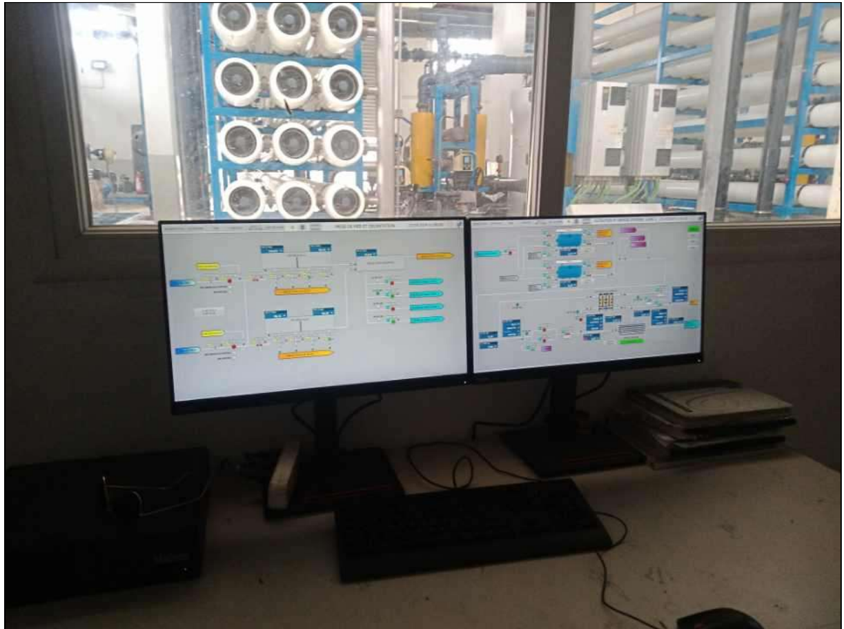
Figure 3. 11 : salle de contrôle de la station.
