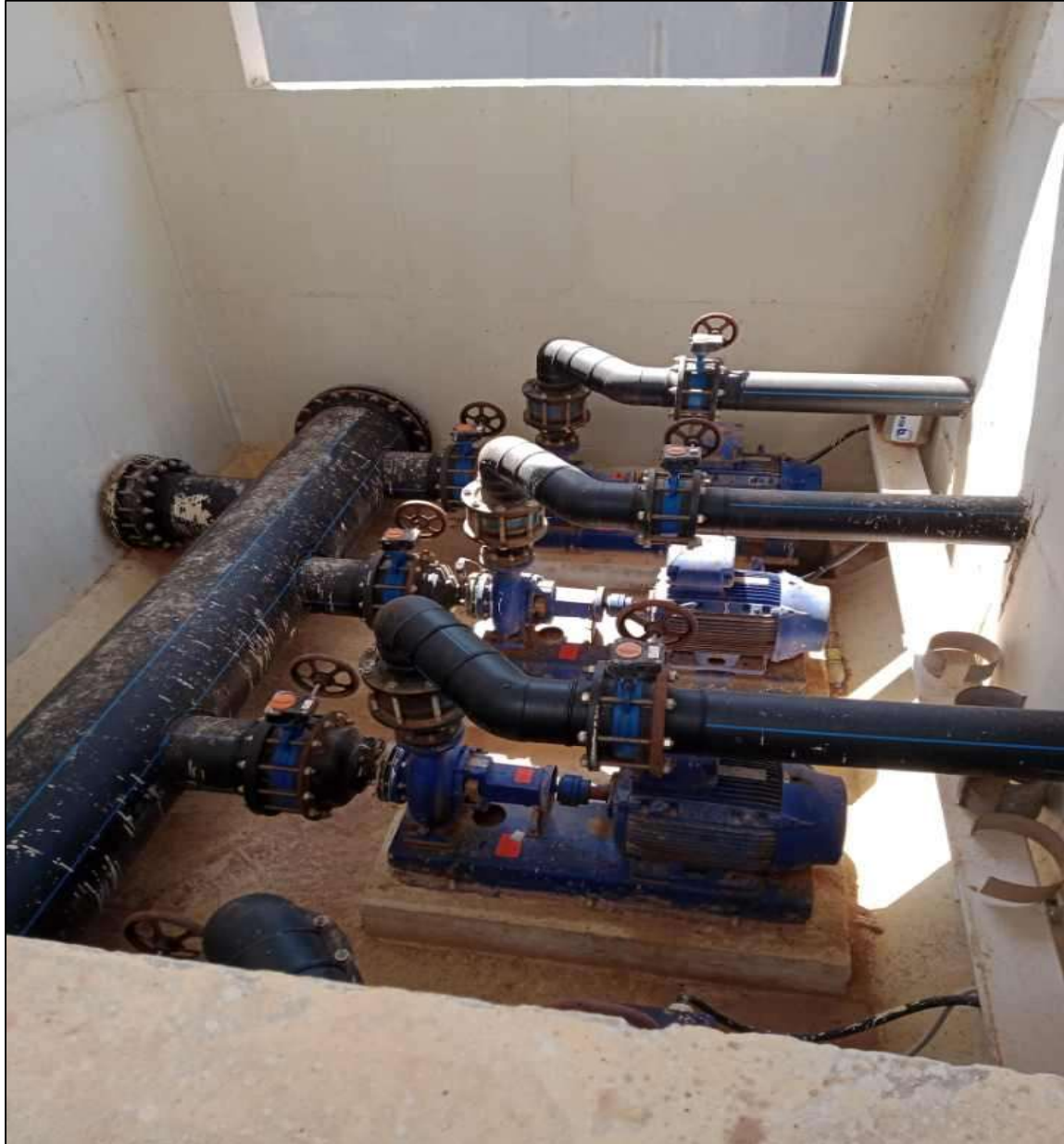
Figure 3. 5 : les pompes centrifuges à axe horizontal.
