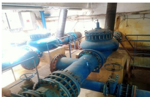
Figure IV.3: conduite générale. (HASSAM, 2024)
