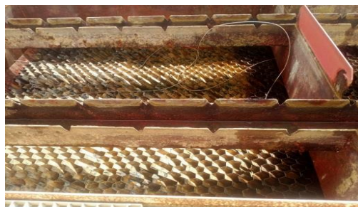
Figure IV.9: Décanteur lamellaire (nid d'abeille)
