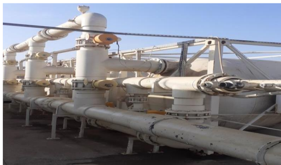
Figure IV.10: Filtres à sable. (HASSAM, 2024)
