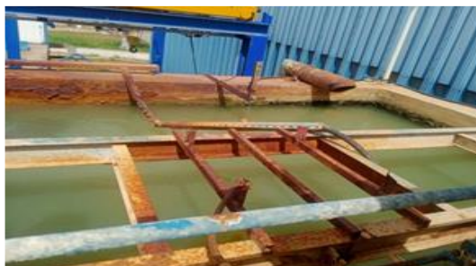
Figure IV.5: Bassin répartiteur. (HASSAM, 2024)
